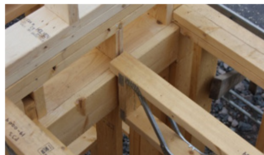
Posi-Joistens överram vilar på utanpåliggande bärlina på väggen.
